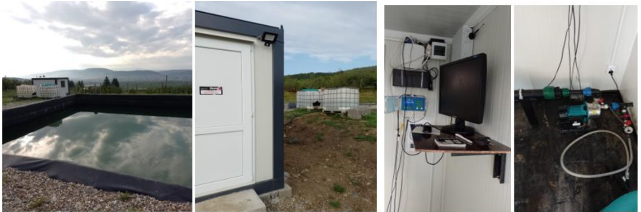
Figura. 18. Bazin cimentat căptușit cu folie EPDM de stocare apă, bazine tampon, echipament automatizare la sistemul de fertirigare
