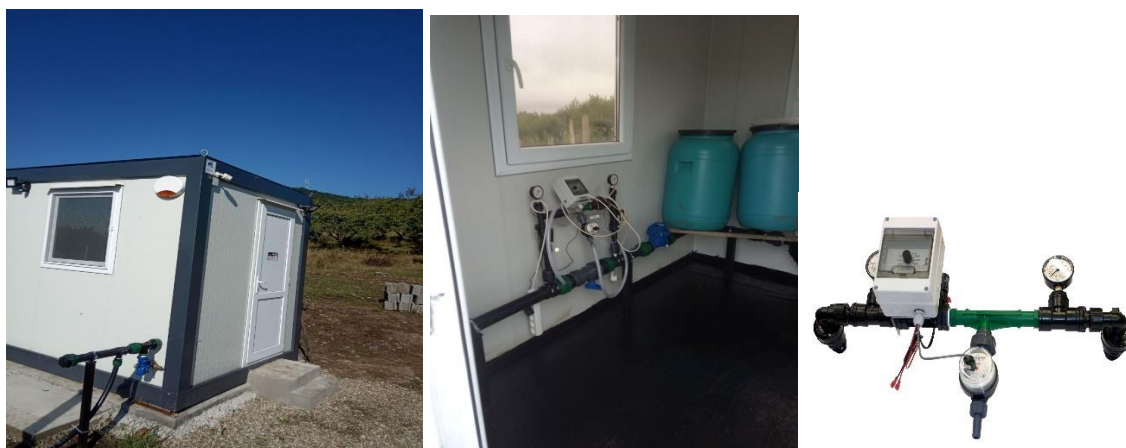
Foto 9. Centru de comandă cu echipamentele de automatizare pentru fertirigare
