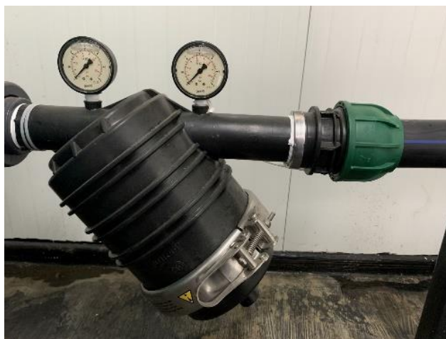
Figura 32. Filtru de linie dotat cu două manometre (sursa:original)
