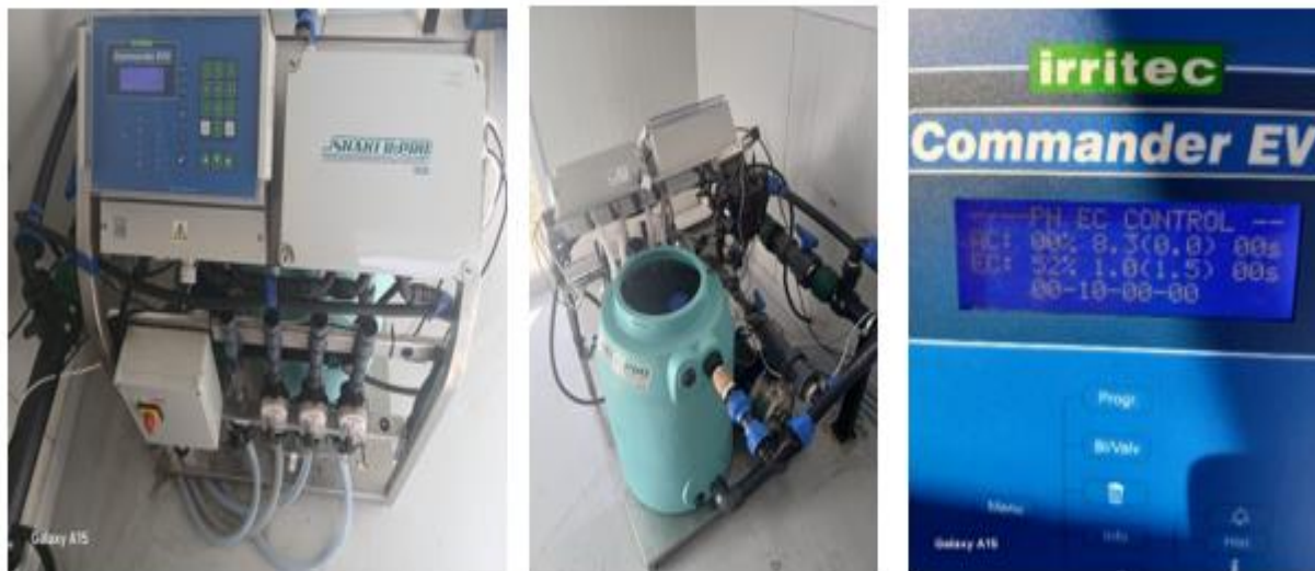
Figura 34. Instalația de fertirigare Irritec- Shaker Pro (sursa:original)
